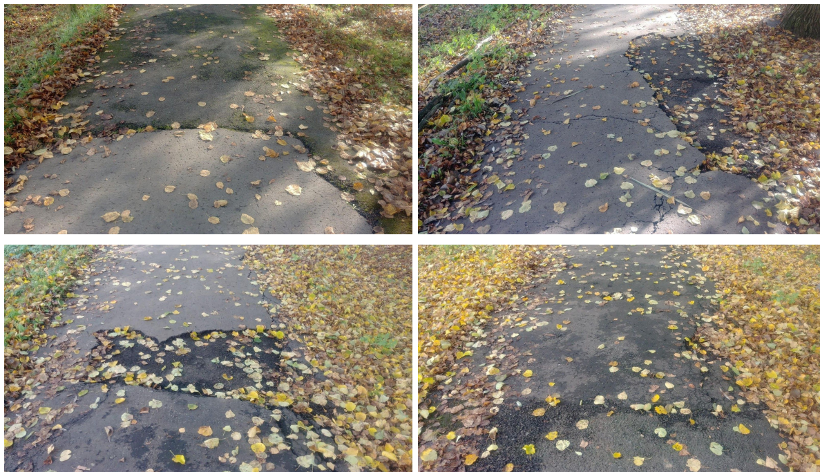
5/2020-1c – Poškození stezky v úseku B přehledové mapy
