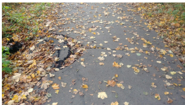
5/2020-1d – Poškození stezky v úseku C přehledové mapy
